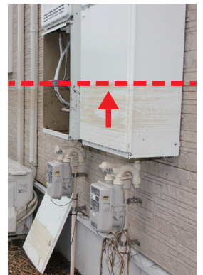
冠水した給湯器
