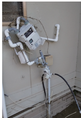
LPガス設備の損傷
